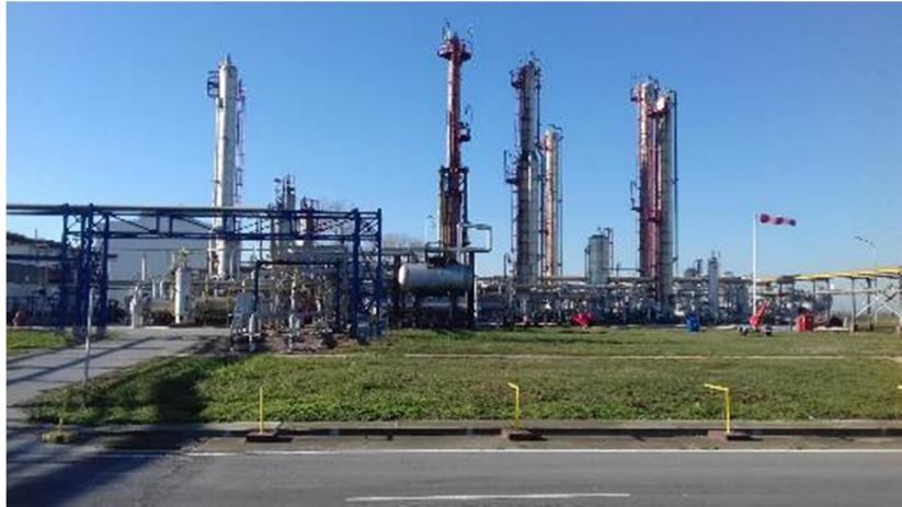
Цевоводи у рафинеријском постројењу
